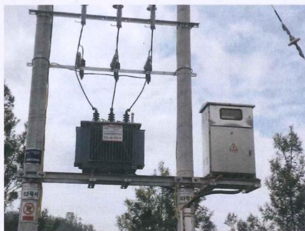
项目市政供电
